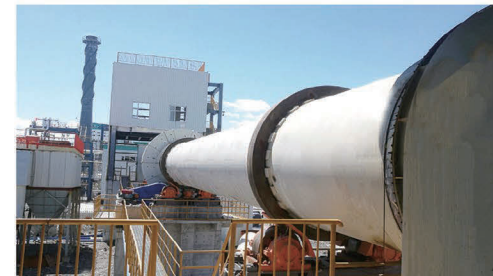
04- 凯赛 (乌苏) 生物材料有限公司 (SH688065) 化工废料资源化再生石灰项目 04-Cathay (Wusu) Biotech Co., Ltd. (SH688065) Chemical Waste Recycling for Lime Production Project
