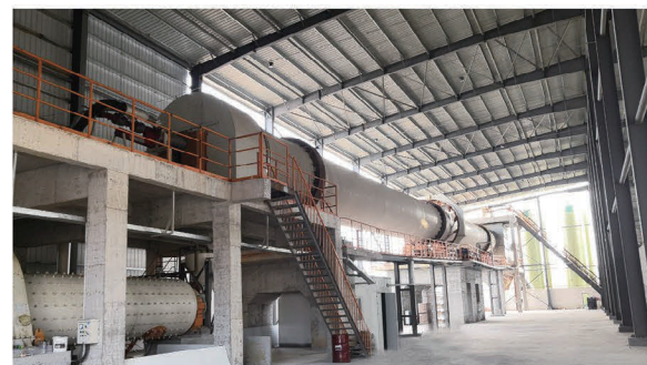
03- 山西太钢不锈钢股份有限公司 (000825) 太原钢城化工日处理 200 吨酸洗污泥项目 03-Shanxi Taigang Stainless Steel Co., Ltd.(000825) Taiyuan 200 t/d Pickling Sludge Treatment Project
