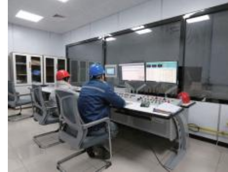
220kV试验中心控制室 220kV test center control room Salle de contrôle du Centre d'essai 220kV
