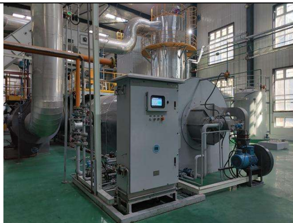
窑炉控制系统 Kiln control system assembly
