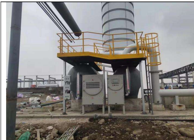
火炬控制系统 Flare control system
