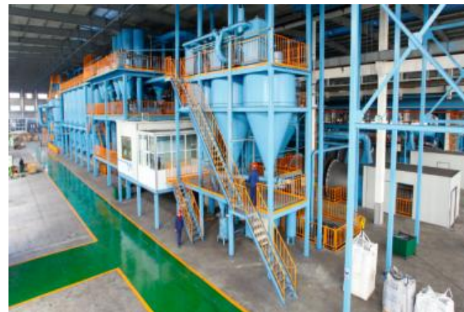
120T/H 砂处理系统 120T/H Sand treatment system
