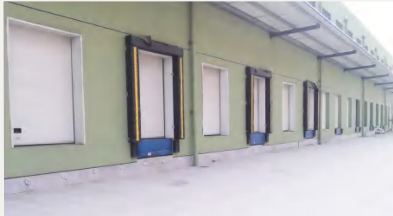
Platform unloading door
