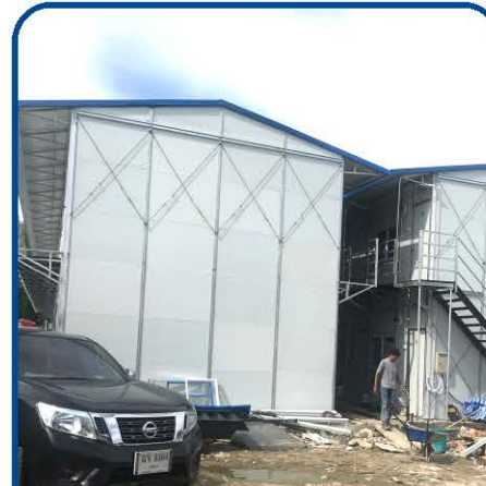
泰国项目 Project in Thailand
