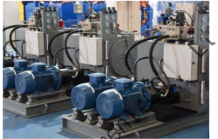
南湾灌区续建配套与现代化改造工程液压系统 Hydraulic system of Nanwan renovation project
