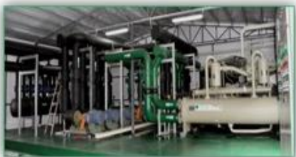
冷水机组系统
